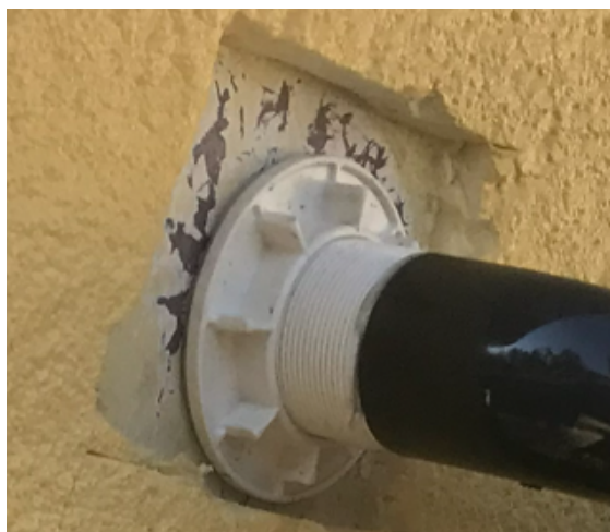
Paluusuutin asennettuna kuvattuna takaa.
