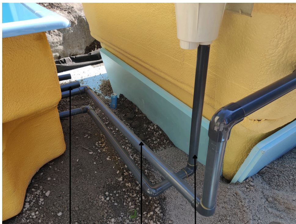
Teknisen tilan tulo- ja paluulinja kytketty tekniseen tilaan
